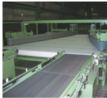
DC-I 物流センターのマジコンベヤ
