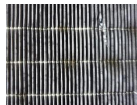
【フィルタろ材上流側】
